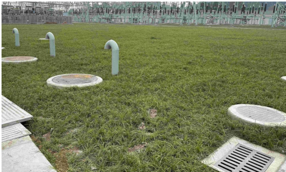
站内主变压器事故油池
