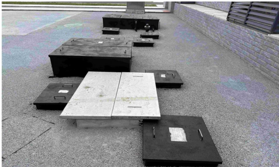
站内地埋式污水处理装置
